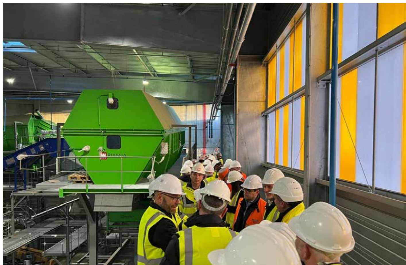
Visite du chantier avec le mandataire du groupement, URBASER Environnement, qui a remporté le Marché Global de Performances pour construire et exploiter le nouveau Centre de tri. Il permettra de répondre à l'extension des consignes de tri obligatoire au 1 er janvier 2023.
